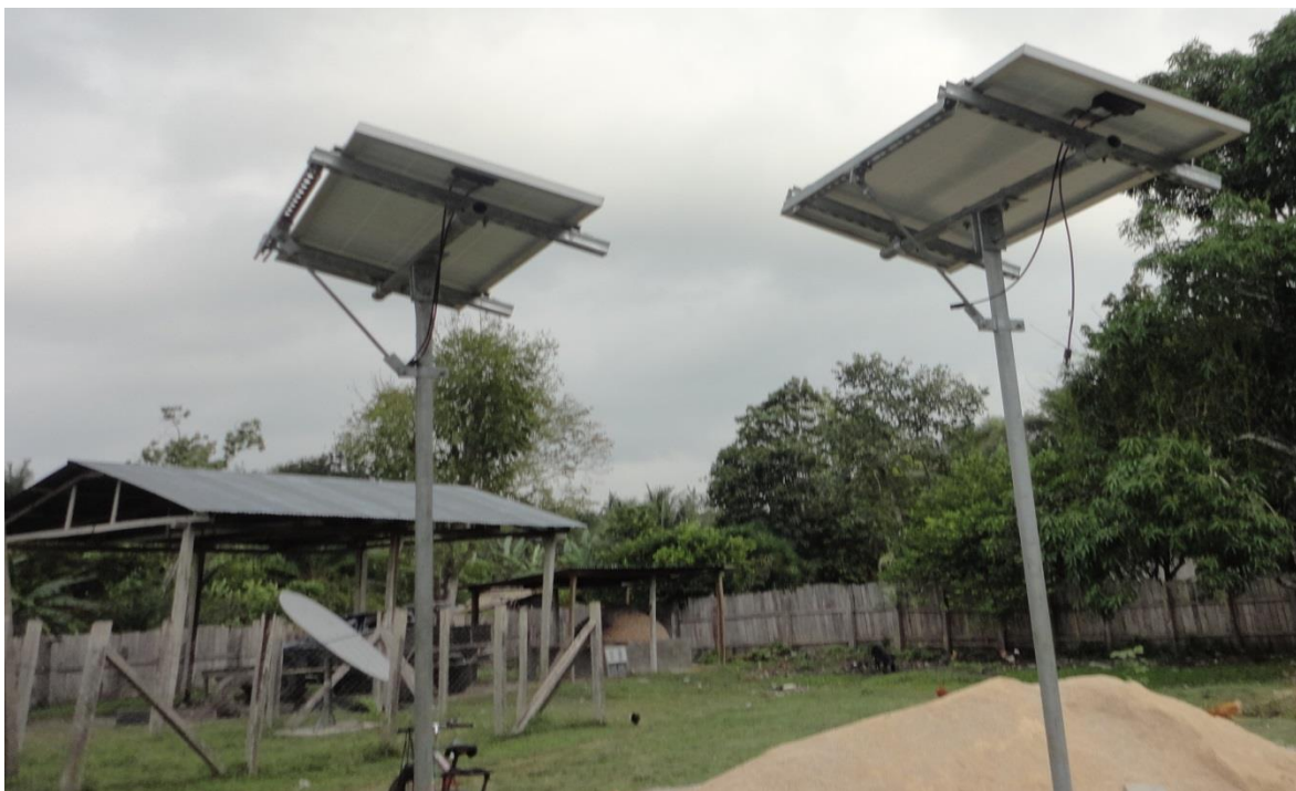
Paneles solares instalados por el INDE in la comunidad de Uaxactún/Foto: WCS
